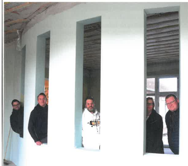
Dieser Verbindungsgang in der Kita „Schwalbennest“ beinhaltet mit der rund geschaffenen Mauer eine kleine architektonische Feinheit, wie (v.l.n.r.) Simon Martens, Dennis Härtel, Malermeister Nick Dietzmann sowie Andrea Möller und Oliver Keese erfreut feststellen konnten.
